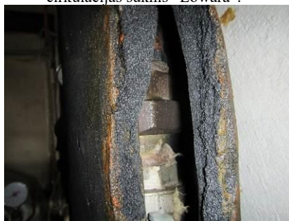
5.6.10. att. Bojāta pretkondensāta čaula cauruļvadam pie ventilācijas iekārtas 4. stāvā.
