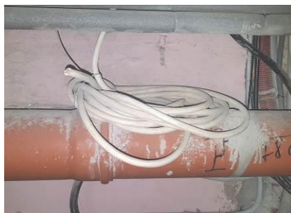
5.9.16. att. Neizolēti, nepievienoti kabeļu gali
