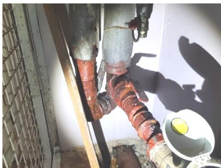
5.1.1.8. att. Aukstā ūdensvada metāla caurules, cauruļvadu korozija
