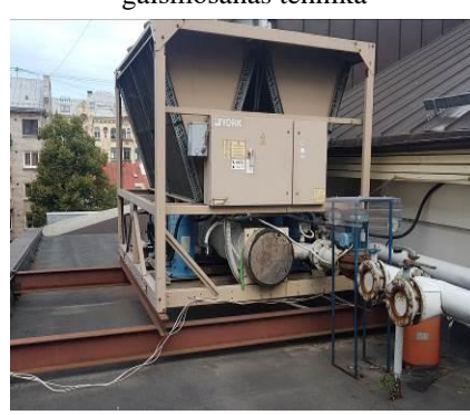
5.9.33. att. Dzesēšanas iekārta uz ēkas jumta
