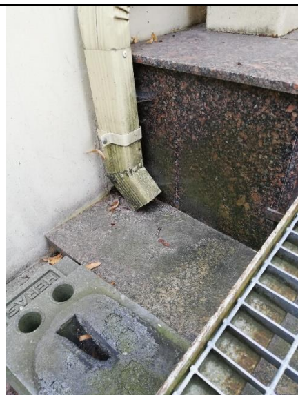
5.1.2.11. Skārda notekcaurules. Ūdens tiek novadīts uz pamatnes, bojājot blakus esošās konstrukcijas
