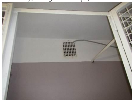
4.16.1. att. Dabīgās ventilācijas atvere ēkas pagrabā (elektrības sadalnes telpa).
