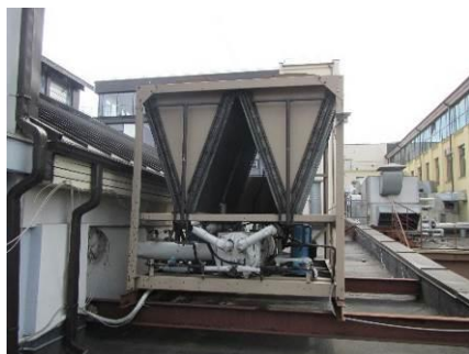
5.6.7. att. Dzesēšanas iekārtas kondensators, kompresori.
