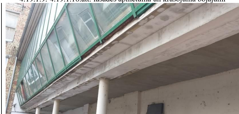
4.19.1.11.att. fasādes krāsojuma bojājumi un nepabeigtie apdares darbi
