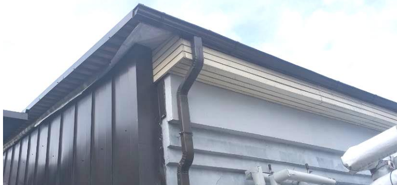
4.8.2.9.att. Hidroizolācijas membrāna nav piestiprināta
