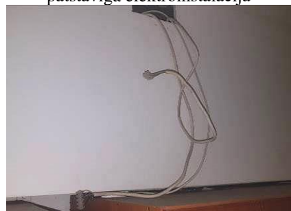
5.9.15. att. Neizolēti, nepievienoti kabeļu gali
