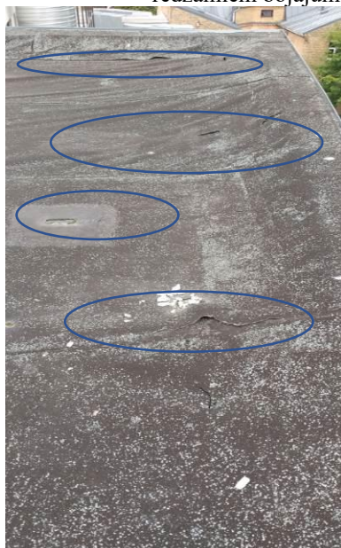
4.8.2.7.att. Savietotā jumta nekvalitatīvs remonts
