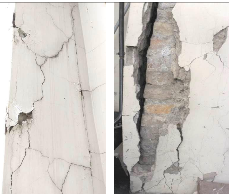
4.19.1.9.-4.19.1.10.att. fasādes apmetuma un krāsojuma bojājumi
