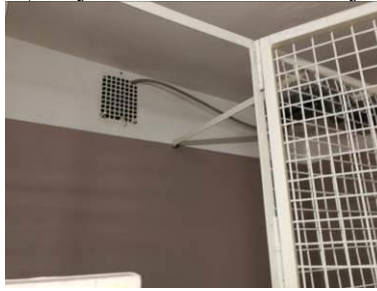
5.3.26. att. Elektroinstalācija, kas ierīkota ventilācijas kanālā
