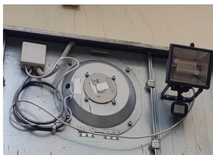
6.7.3. att. Nenostiprināts, videi neatbilstošs kabelis
