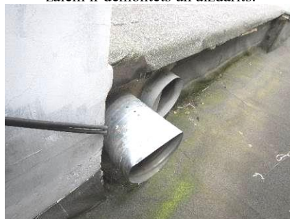
4.16.4. att. Ventilācijas atveres uz ēkas jumta bez aizsargrestēm.
