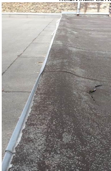
4.8.2.11.att. Jumta līmeņu nekvalitatīvs savienojums un bojāts segums
