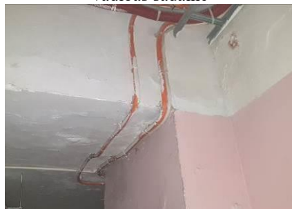
5.9.25. att. Ugunsdzēsības sūkņu vadības sadalnes barojošie kabeļi
