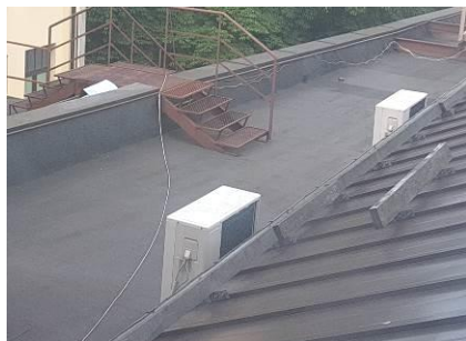
5.9.38. att. Nenostiprināts kabelis
