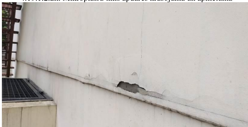
4.19.1.3.att. fasādes apmetuma un krāsojuma bojājumi
