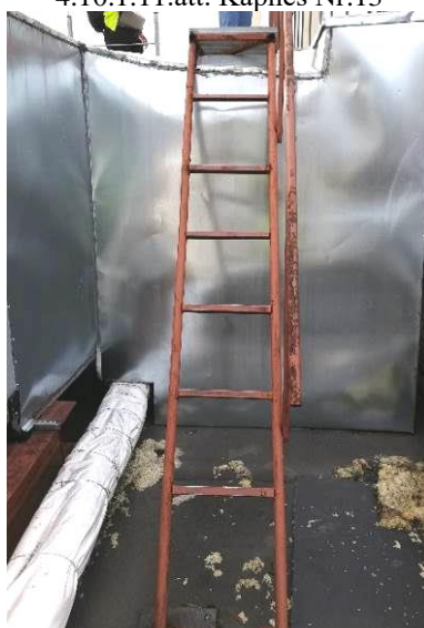
4.10.1.13.att. Metāla kāpnes nokļūšanai pie ventilācijas iekārtām.
