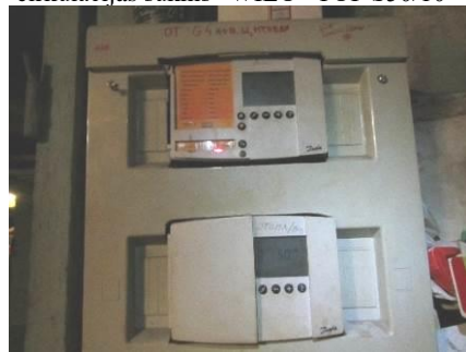
5.4.6. att. Ventilācijas apkures (augšējais), radiatoru apkures un karstā ūdens apgādes sistēmas (apakšējais) kontrolieri.
