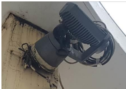
6.7.1. att. Nenostiprināti kabeļi
