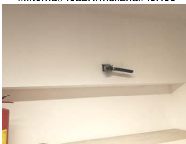
5.3.20. att. Noslēgarmatūra, kas izvietota uz iekšējā ugunsdzēsības ūdensvada
