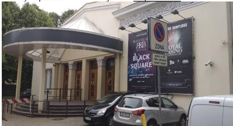
4.19.1.1.att. Ēkas galvenā fasāde, plaisas krāsojumā
