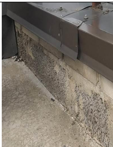
4.2.3.5.att. Daļa nesošo sienu būvētas no keramzītbetona blokiem. Ārsiena virs jumta daļas nav aizsargāta ar apdari
