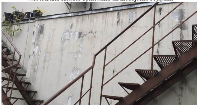
4.19.1.4.att. fasādes apmetuma un krāsojuma bojājumi
