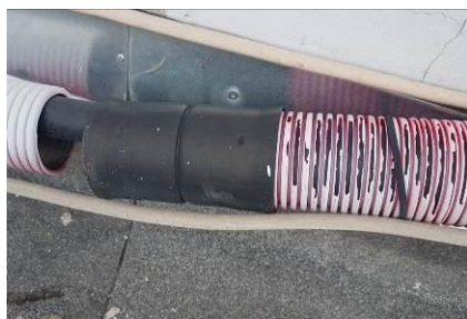
5.9.36. att. Bojāta kabeļa aizsargcaurule
