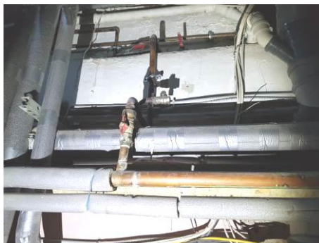
5.1.1.4. att. Aukstā ūdensvada vara caurules, nav uzstādīta pretkondensāta izolācija
