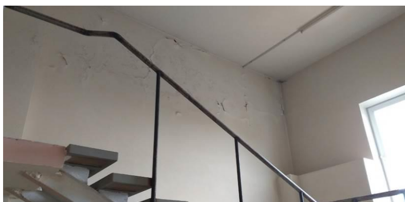
4.18.1.3.att. Sienas ar apmetumu, emulsijas krāsas bojājumi ēkas kāpņu telpā
