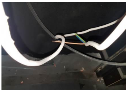
5.9.5. att. Neizolēti kabeļu gali, 1.stāva kluba telpas
