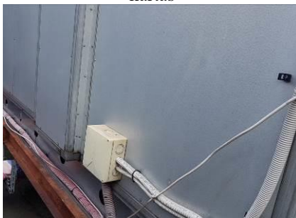
5.9.39. att. Videi neatbilstoši kabeļi (baltie kabeļi)
