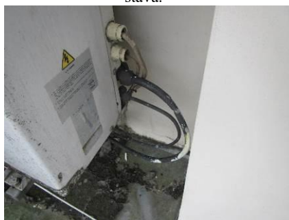
5.6.12. att. Bojāta cauruļvadu izolācija pie dzesētājiem ēkas austrumu fasādē.
