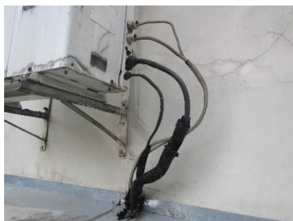
5.6.11. att. Bojāta cauruļvadu izolācija pie dzesētājiem ēkas austrumu fasādē.
