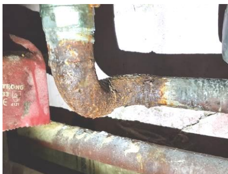
5.1.1.6. att. Aukstā ūdensvada metāla caurules, cauruļvadu korozija
