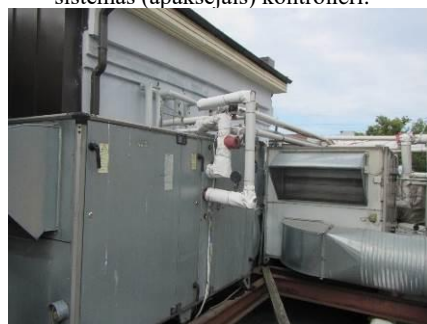
5.4.8. att. Ventilācijas iekārtu apkures vadības sistēmas ar trīsceļu vārstiem un cirkulācijas sūkni. Izvietots pie iekārtas uz jumta.
