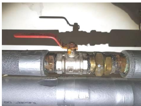
5.1.1.5. att. Aukstā ūdensvada vara caurules un ventilis, konstatēts kondensāts
