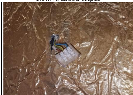
5.9.9. att. Neizolēti kontaktsavienojumi, 1.stāva kluba telpas
