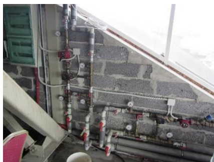
5.4.7. att. Ventilācijas iekārtu apkures vadības sistēmas ar trīsceļu vārstiem un cirkulācijas sūkni. Izvietots tiekštelpā.
