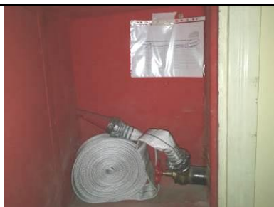
5.3.17. att. Aprīkojums iekšējos ugunsdzēsības krānu skapjos
