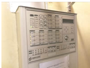
5.3.19. att. Ugunsdzēsības sūkņu stacijā izvietotā uztveršanas, kontroles un indikācijas iekārta
