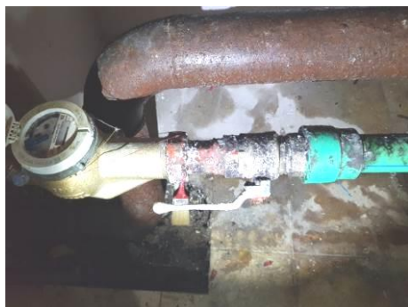
5.1.1.7. att. Aukstā ūdensvada metāla caurules, cauruļvadu korozija
