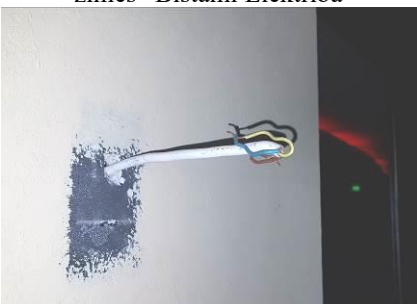
5.9.6. att. Neizolēti kabeļu gali, 1.stāva kluba telpas
