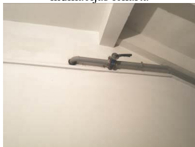
5.3.21. att. Noslēgarmatūra, kas izvietota uz iekšējā ugunsdzēsības ūdensvada
