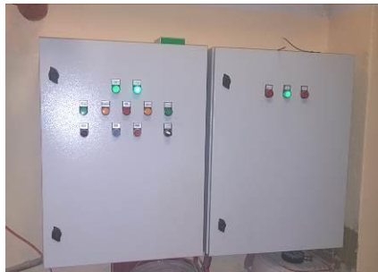
5.9.23. att. Ugunsdzēsības sūkņu vadības sadalne
