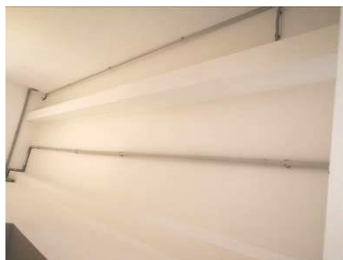
5.3.9. att. Telpa bez automātiskās ugunsgrēka atklāšanas un trauksmes signalizācijas sistēmas ugunsgrēka detektora
