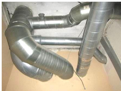
4.16.5. att. Ēkā uzstādīti pārsvarā apaļa šķērsriezuma gaisa cauruļvadi
