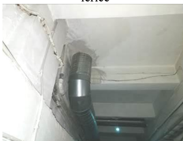
5.3.24. att. Starpstāvu pārsegumu šķērsojošās inženierkomunikācijas
