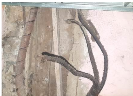
5.9.21. att. Nedemontēts kabelis
