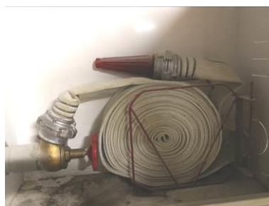
5.3.16. att. Aprīkojums iekšējos ugunsdzēsības krānu skapjos
