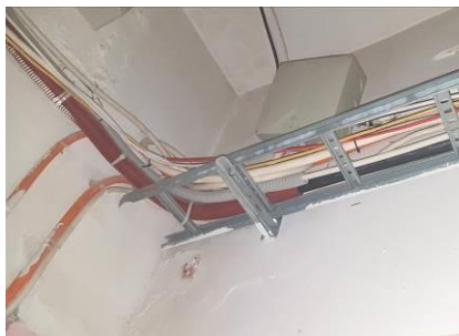
5.9.26. att. Ugunsdzēsības sūkņu vadības sadalnes barojošie kabeļi
