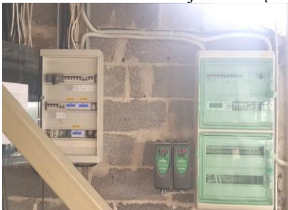
5.9.28. att. Ventilācijas iekārta vadības sadalne
