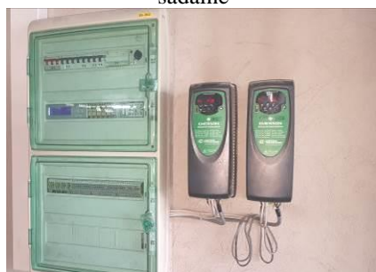
5.9.29. att. Ventilācijas iekārta vadības sadalne
