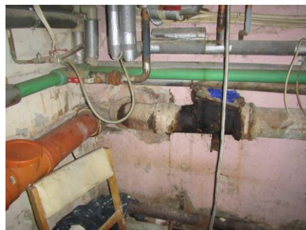
5.1.2.8.att. Vecs čuguna kanalizācijas cauruļvads
