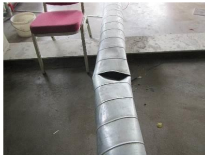
4.16.6. att. Mehāniski bojāts gaisa vads ēkas 4. stāvā (Inventarizācijas lietā telpa Nr. 195)
