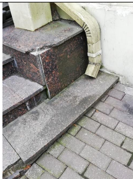
5.1.2.12. Skārda notekcaurules. Ūdens tiek novadīts uz pamatnes, bojājot blakus esošās konstrukcijas
