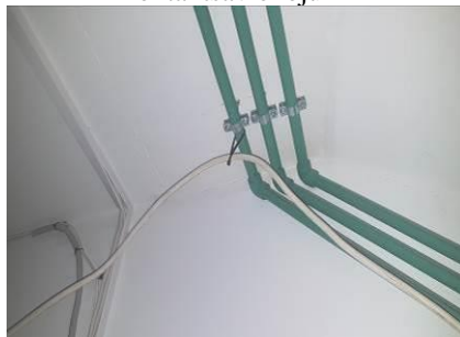
5.9.20. att. Kabelis stiprināts pie ūdens caurules
