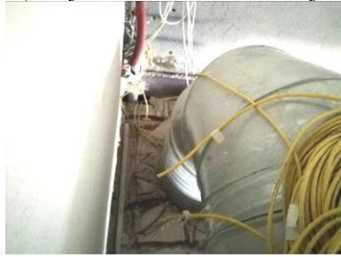
5.3.25. att. Starpstāvu pārsegumu šķērsojošās inženierkomunikācijas
