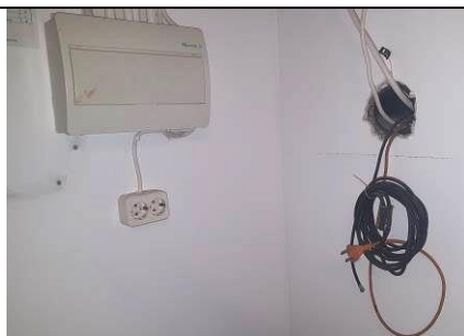
5.9.13. att. Pagarinātais ekspluatēts kā patstāvīga elektroinstalācija
