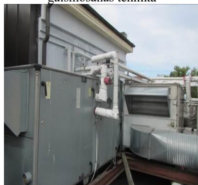
5.9.32. att. Ventilācijas iekārtas uz ēkas jumta
