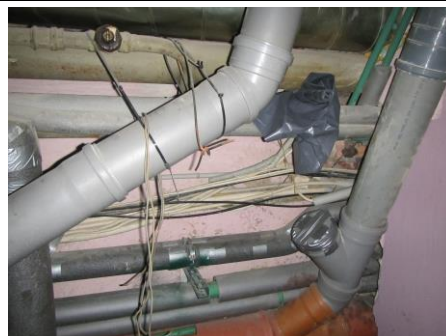
5.1.2.6.att. Kanalizācijas maģistrālie cauruļvadi ar neatbilstošiem stiprinājumiem
