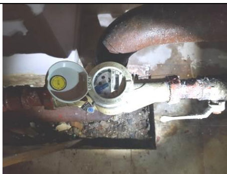
5.1.1.2. att. Aukstā ūdensvada ievads, ūdens patēriņa skaitītājs
