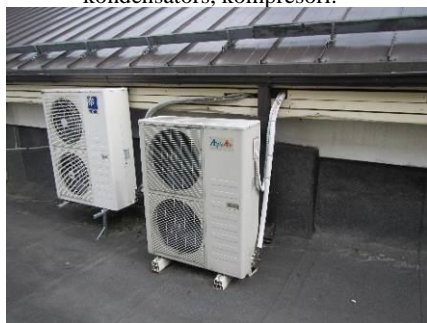
5.6.9. att. Individuālo dzesēšanas iekārtu ārējie bloki (kondensatori).
