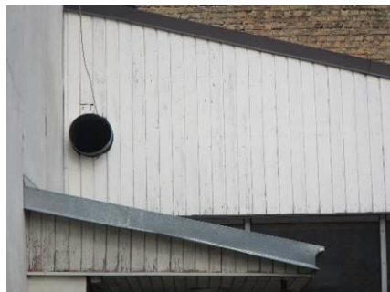
4.16.3. att. Gaisa vada izvads no piebūves ēkas austrumu pusē ir bez restēm.
